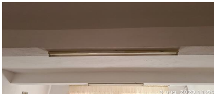
Figura 10 - Corp de iluminat
